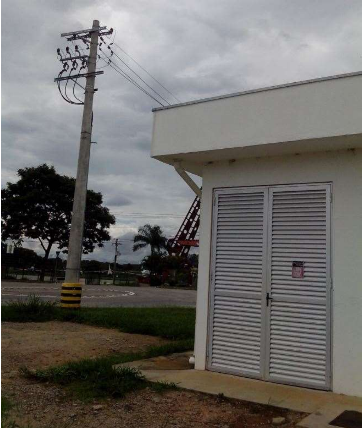
Cabine Primária e poste com a linha aérea da concessionária Bandeirante, em MT
