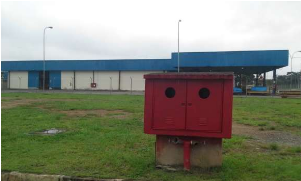
Área verde com hidrante e caixas de passagem
