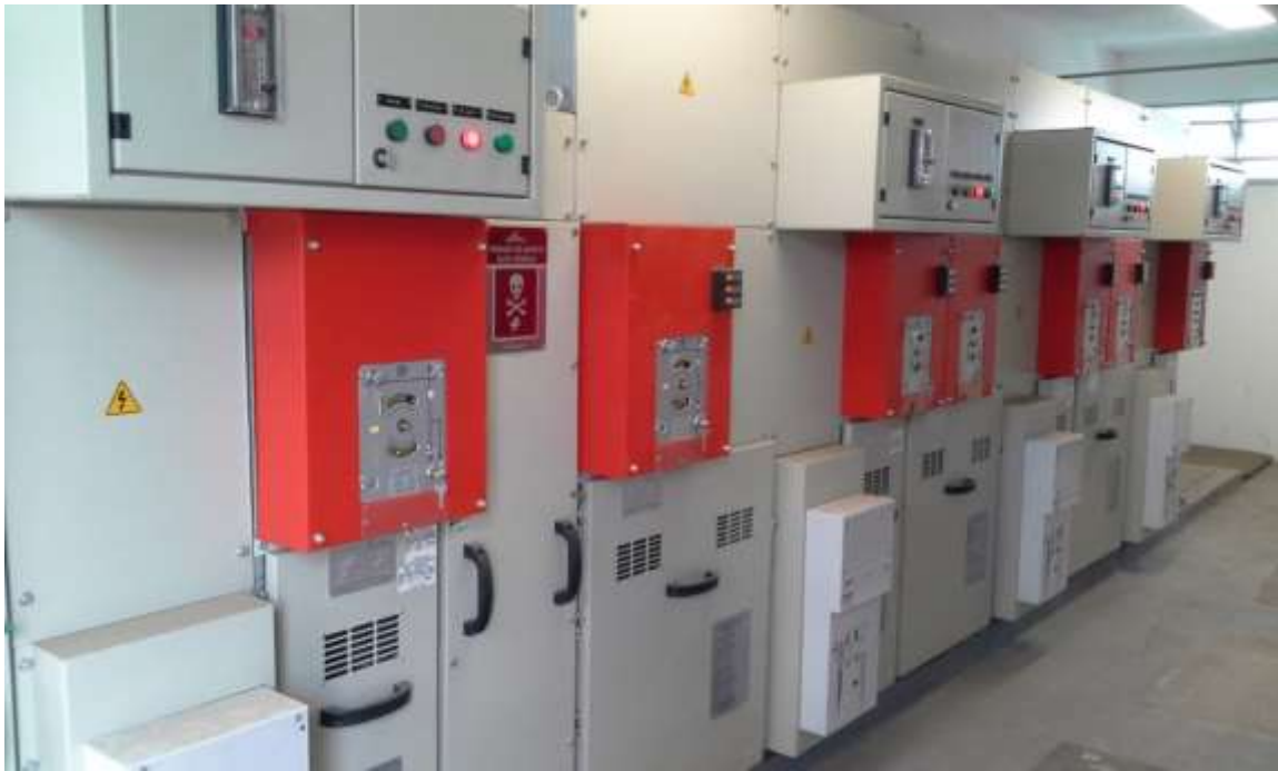
Cabine Primária - interior
