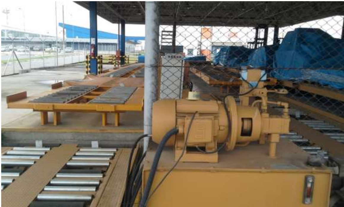
Equipamentos mecânicos para movimentação de carga
