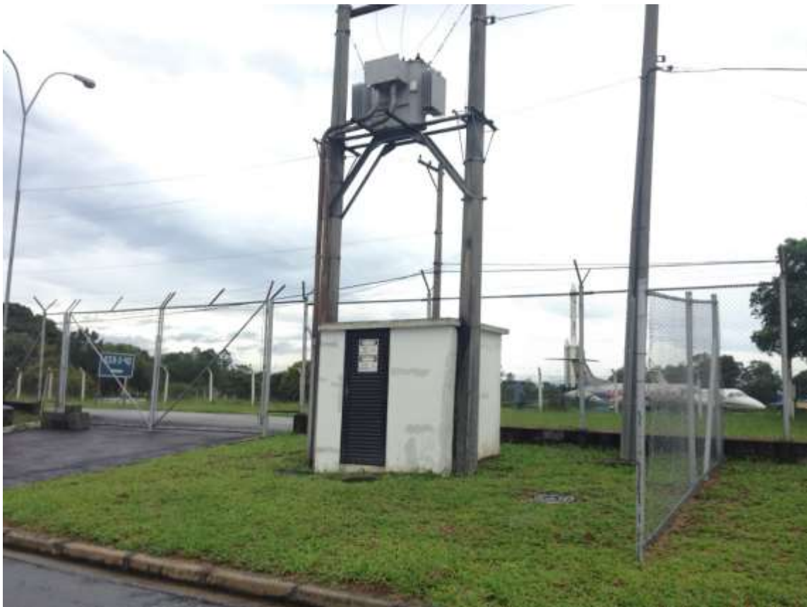
Transformador e Cabine de Distribuição em BT
